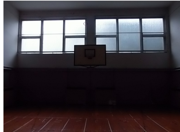
Figura 8.1 - Particolare serramenti da sostituire.
